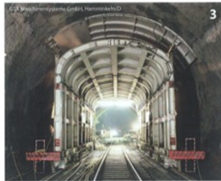
Stützplatten in der Firste zur Vorbruchsicherung Support plates in the roof to prevent caving
