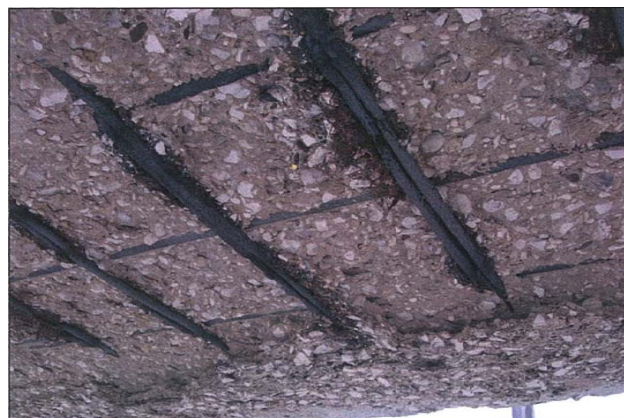
図-3 コンクリートのはく離
